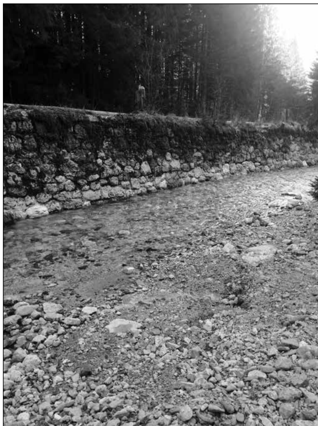
Obrežna zaščita s kamnometom ob potoku Begunjščica v dolini Drage na Gorenjskem
